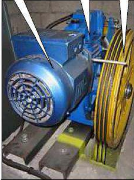
Motorisation de la cabine
