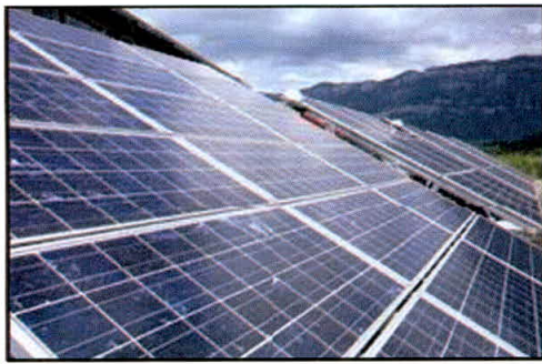
a – Panneaux solaires.
