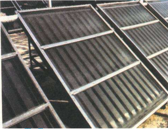
ألواح شمسية لإنتاج الكهرباء
